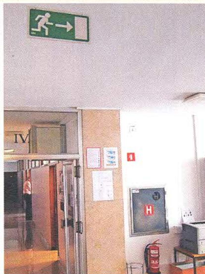
Požarni red, označene evakuacijske poti in gasilnik v Domu sindikatov na Dalmatinovi 4 v Ljubljani.
